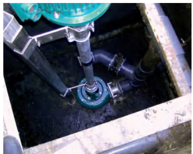
运行中的LHP长轴高压泵 | LHP in use
