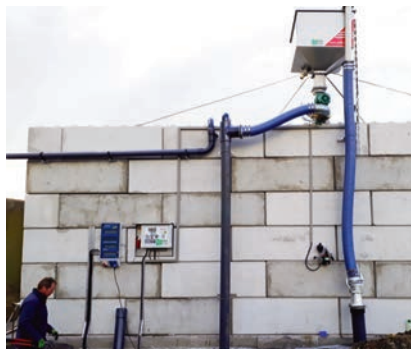
Der Separator wurde auf diesem Kuhbetrieb auf einer Betonwand befestigt, um die Feststoffe darunter zu sammeln. The separator is installed on a concrete wall on a cow farm to collect the dry material below.
