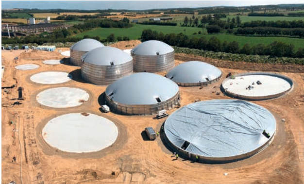
Biogasprojekt mit 14 Fermentern Biogas project with 14 digesters
