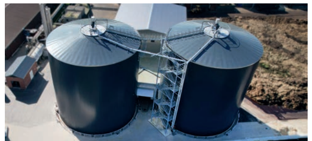
Zwei Hochfermenter auf Biogasanlage Two CSTR at a biogas plant
