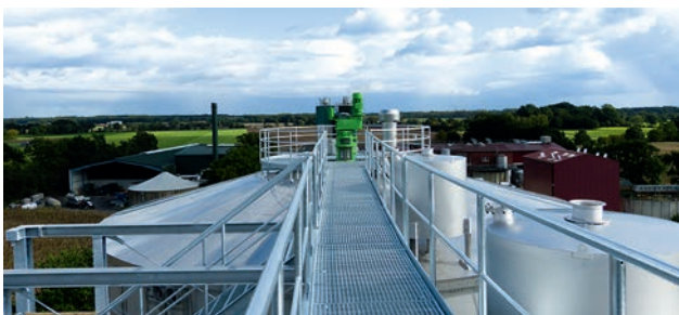
Zwei zentralgerührte Fermenter mit Zentralrührwerk Two continuous stirred tank reactors with central stirring system
