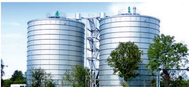
Zwei zentralgerührte Fermenter vor Isolierung und Verkleidung Two continuous stirred tanks before insulation and cladding
