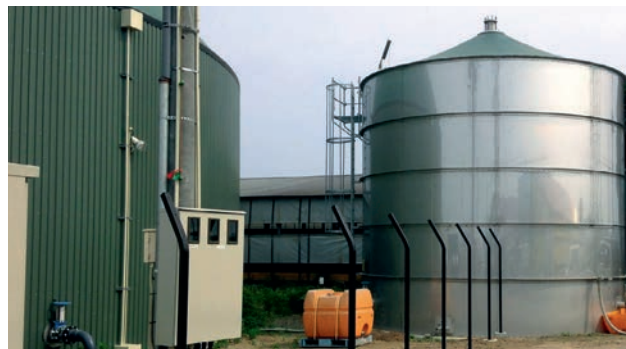
Vorlage- und Pufferbehälter in Japan Hopper and buffer tank in Japan
