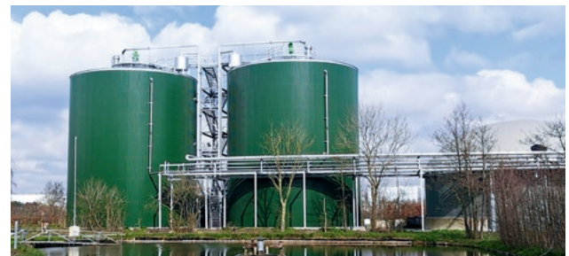
Zentralgerührte Fermenter nach Fertigstellung Continuous stirred tanks upon completion
